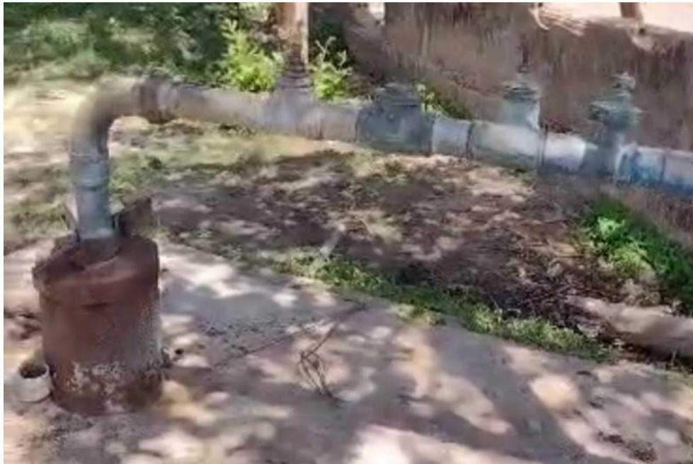
O poço de responsabilidade da Caema apresentou problemas
